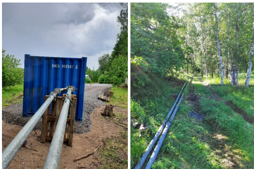
Figur 2. Exempel på en brunnsöverbyggnad (t v) samt ledningar förlagda på marken (t h) (Foto: Midvatten).
