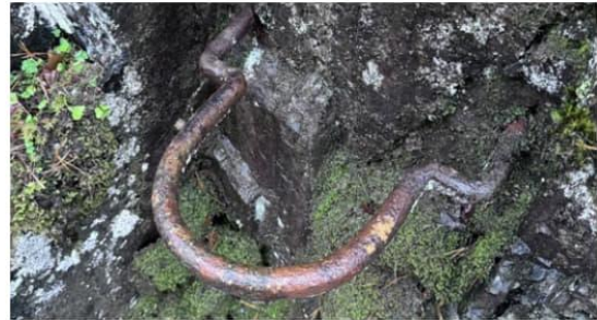
Fäste för telegrafstolpe i berg vid tågbanan vid Östra Hagen
